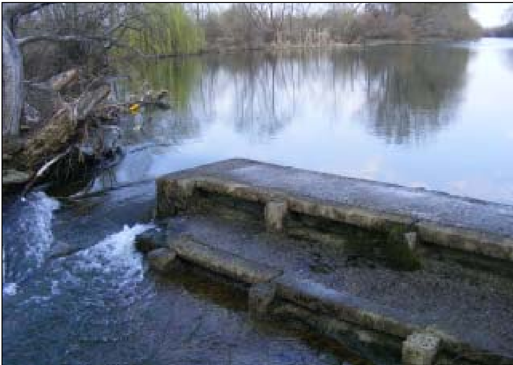
13. ábra A gáttest balparti bekötése, az előregyártott betonelemek jó állapotban vannak
